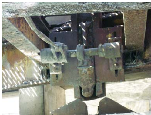
Foto 3. Mecanismo de transmisión hasta el cierre central en los extremos del puente
